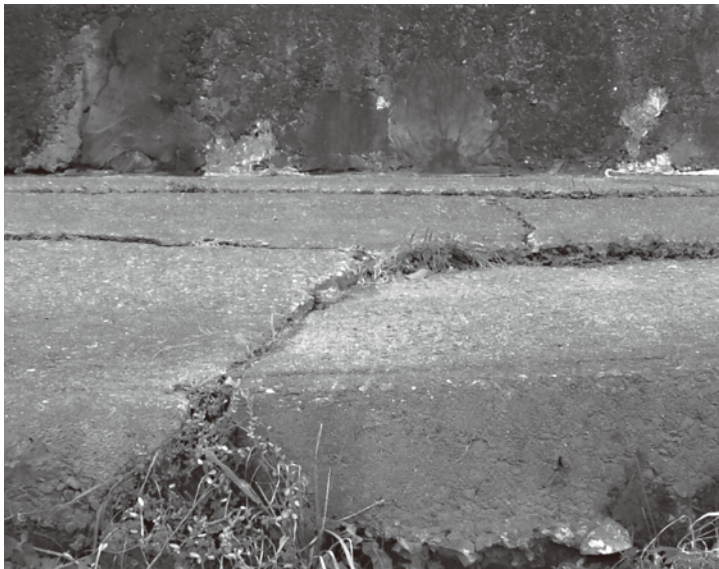
崩れかけた町道
