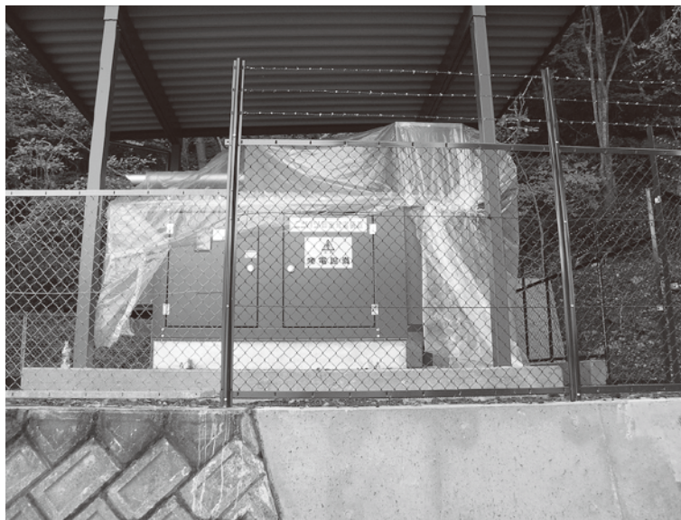
震災後に設置された発電機(船津・丸山配水池)
