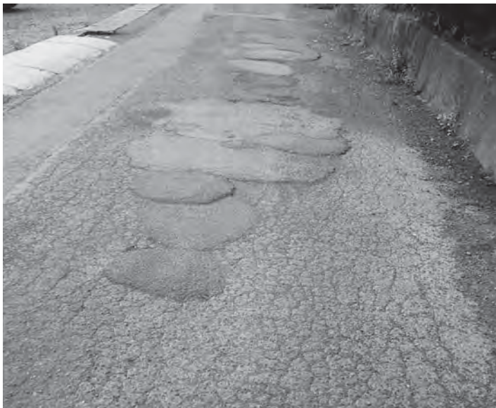
痛んでいる道路
