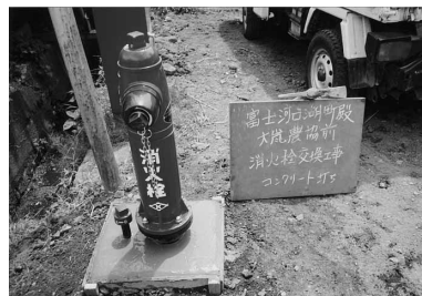
回転式の消火栓
