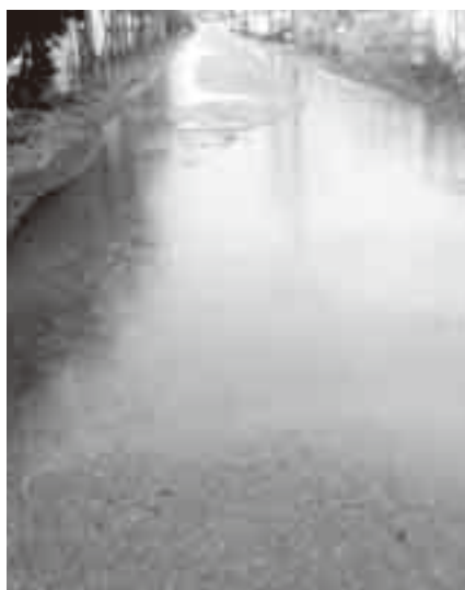
降水時、水が溜まる町道
